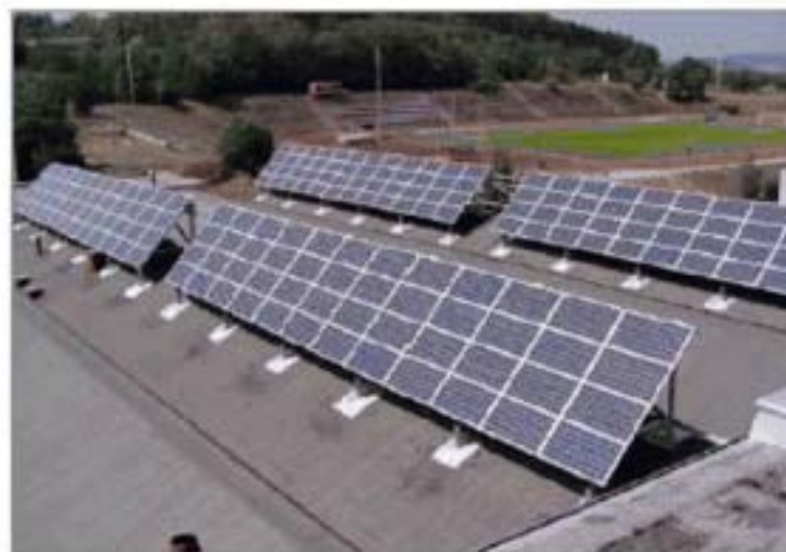
Střešní instalace na VUT v Brně.
